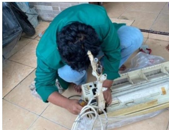
Gambar 1. Memerbaiki AC yang mengalami kerusakan pada pendinginnya.
